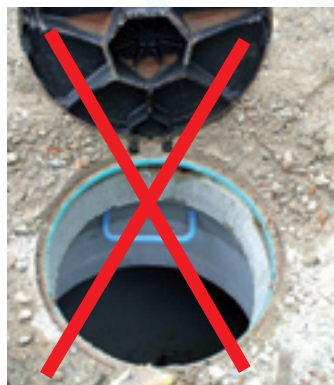
Accès dangereux (un seul échelon)
