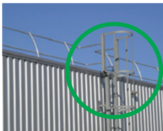
Accès technique sécurisé
